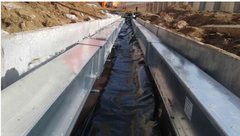
Рис. 11. Смонтированные шинопроводы KLM-S AL-25 68 с IP 68 на 2500 А в ЖБК типового изготовления, до закрытия канала крышкой
