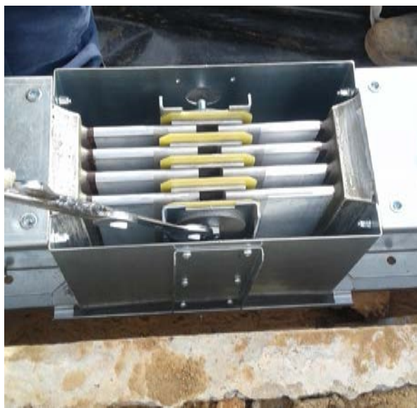
Рис. 6. Установка соединительного сжима на стыковочный элемент с затягиванием болта моментным ключом перед заливкой компаундом
