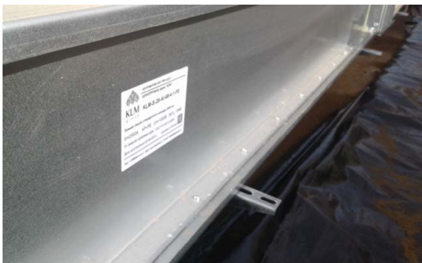
Рис.10. Вид прямой секции шинопровода серии KLM-S AL-25 на 2500 А с IP 68, установленной в ЖБК-канале
