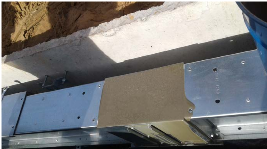
Рис. 7. Вид стыковочного элемента шинопровода после заливки компаундом
