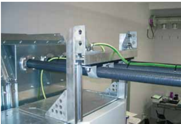
DURESCA 12 кВ 1250 А Вход токопровода в ячейку с воздушной изоляцией
