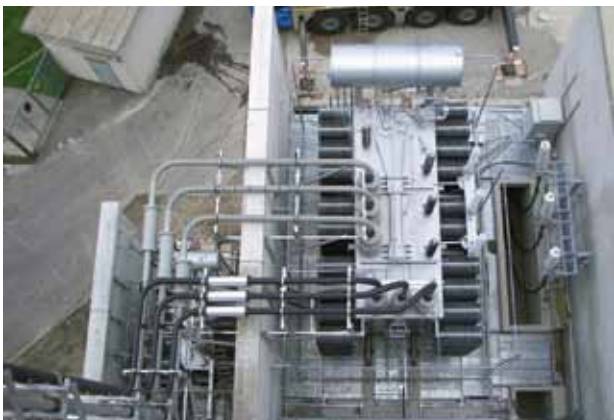
Подключение к трансформатору закрыто защитными боксами
