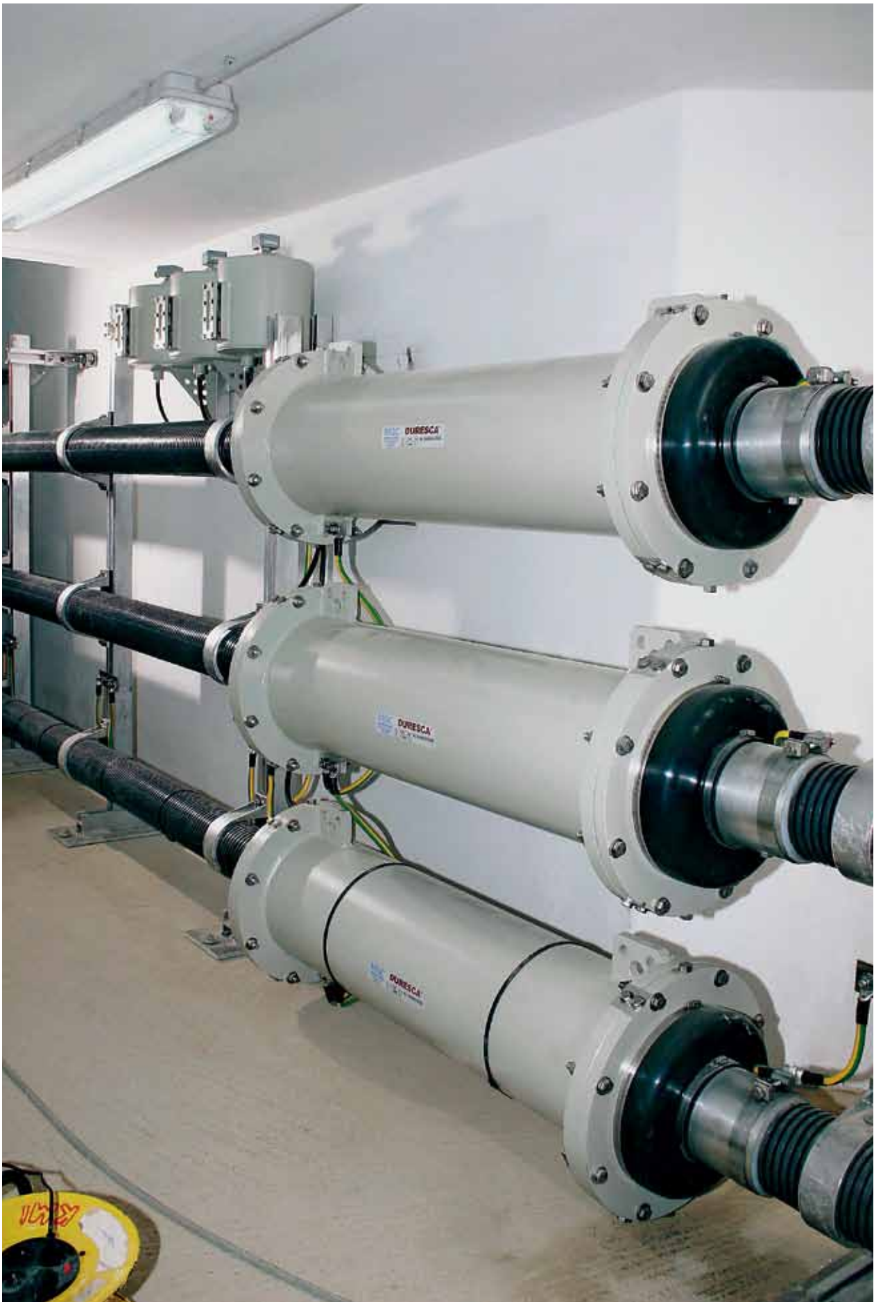
Токопровод DURESCA 123 кВ 2000 А
