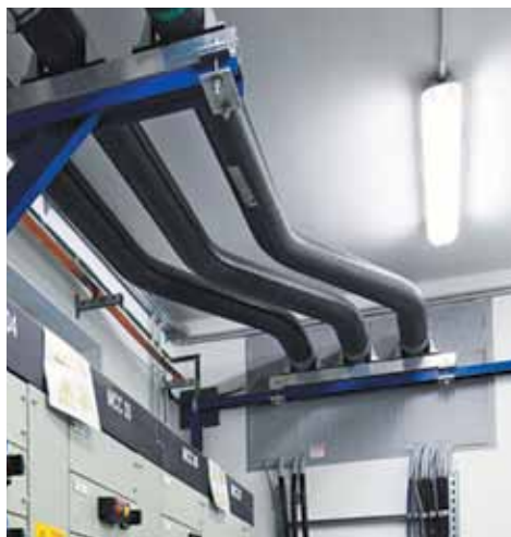
DURESCA 12 кВ 3150 А Проход через стену
