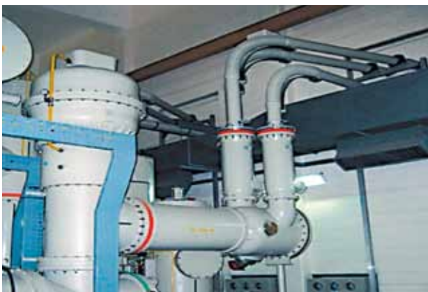
DURESCA 145 кВ DG 2000 А. Подключение к КРУЭ 145 кВ
