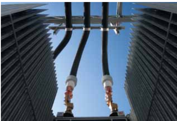
Подключение к трансформатору, наружное исполнение
