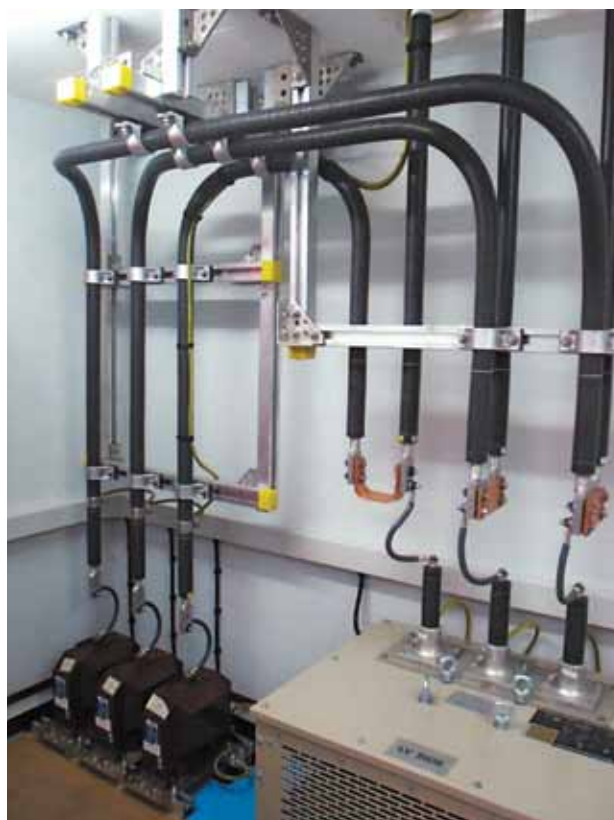
Подключение измерительных трансформаторов к линии токопровода
