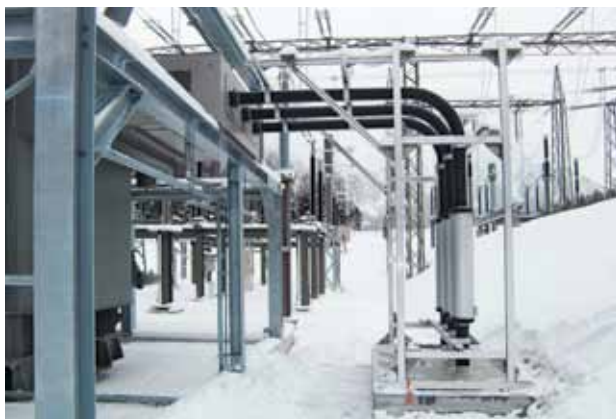
DURESCA 17 кВ 2500 А Подключение к трансформатору (Подстанция, Швейцария)
