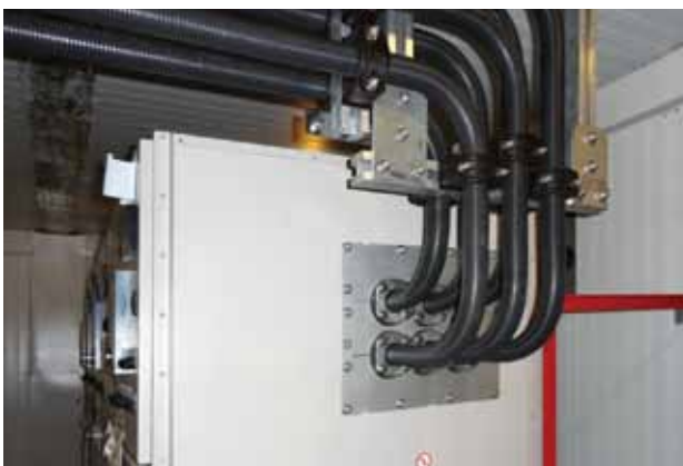
DURESCA 12 кВ 1250 А Подключение токопровода к ячейкам с элегазовой изоляцией
