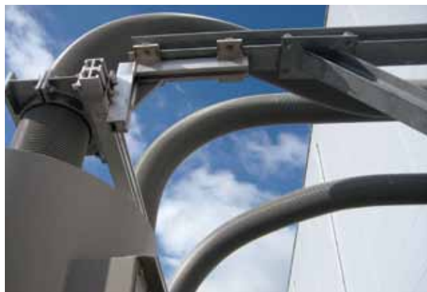
DURESCA 24 кВ 7000 А. Токопровод цепи генератора, подключение к силовому трансформатору (Дания)
