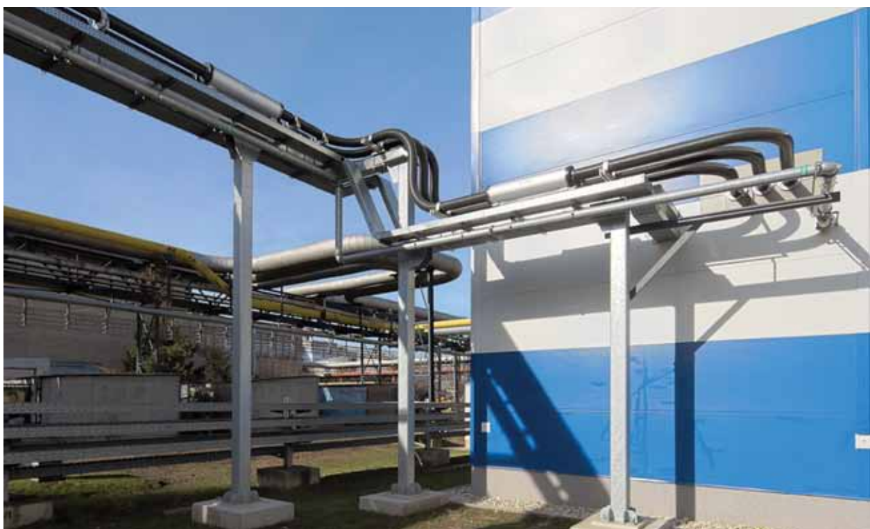
DURESCA 17 кВ 3150 А (ТЭЦ, Словакия)
