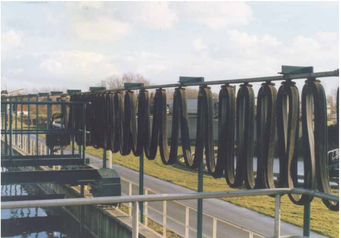
AKAPP-система перемещения плоских электрокабелей на станции водоочистки
